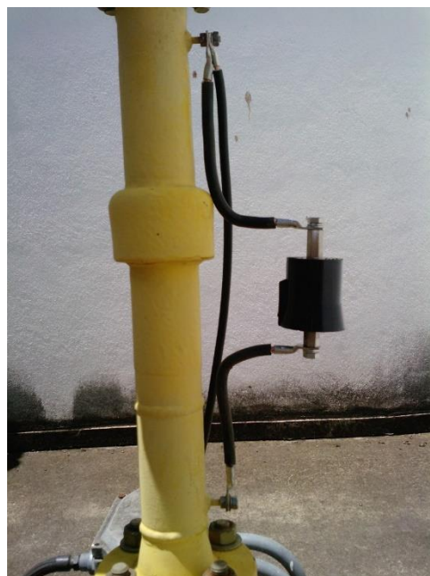
Figura 2 - Exemplo real de instalação de DPS
